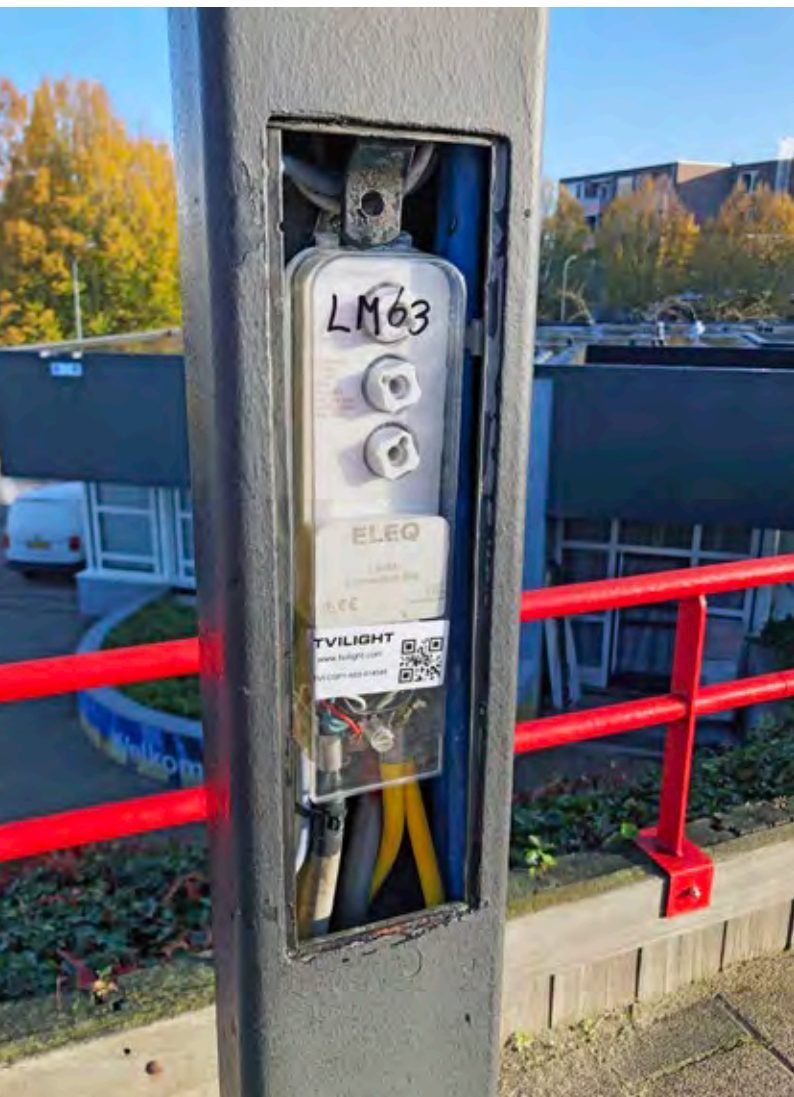
Eleq aanraak veilige spatwater dichte aansluitkast in mast op Helmond.
