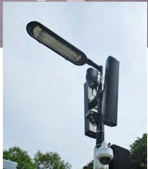
'Totempaal' in Zuidhorn: een mast met een verlichtingsarmatuur, 2 luidsprekers, een camera en een straalzender.
