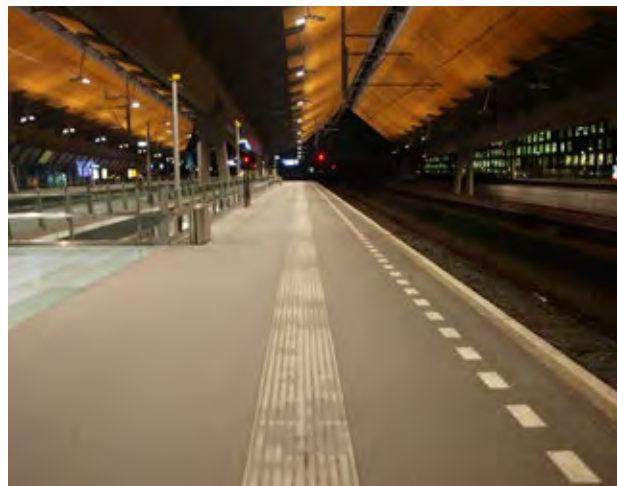
De situatie voor de led vervanging. Een groot deel van de uplighters was defect.
