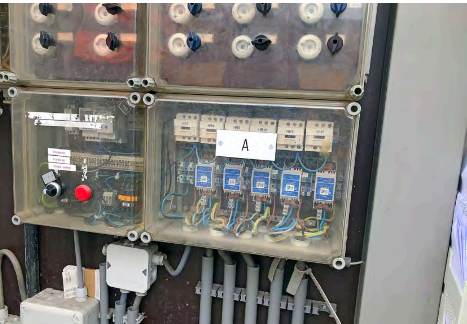
De schakelkast in Blerick is naar aanleiding van de ervaring in Olst ook voorzien van 5 inschakelpiek begrenzers. Bovenin nog de oude smeltpatronen. De zwarte en rode knop links zijn voor de handmatige overbrugging (om de verlichting overdag te kunnen testen).
