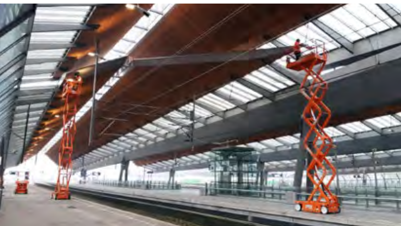
Vervanging van de 444 up- en downlighters boven de perrons, in een buitendienststelling in week 52 van 2020, op 17 meter hoogte.
