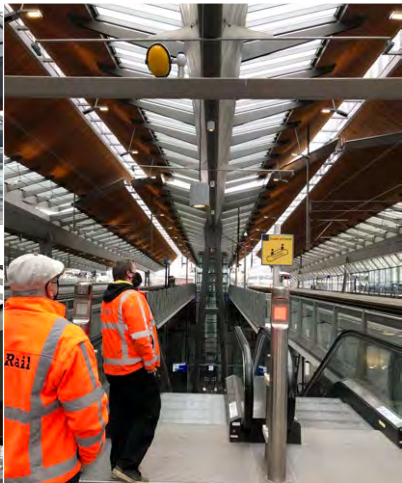
Spot boven de roltrap met een zonneschermliertje laten zakken want op roltrap kan geen hoogwerker.
