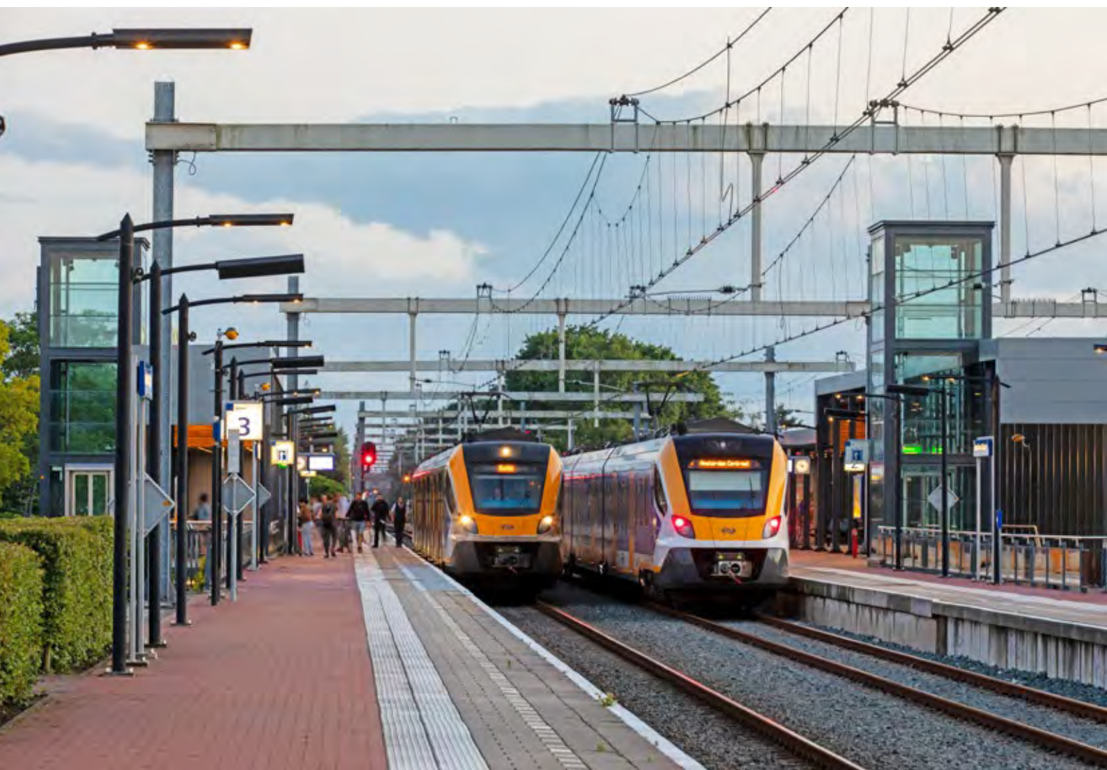
Station Vathorst na de led vervanging. De aparte luidsprekermasten tussen de lichtmasten zijn goed te zien. Zo'n woud van masten willen we met de Multi Purpose mast (zie hoofdstuk 18) voorkomen.
