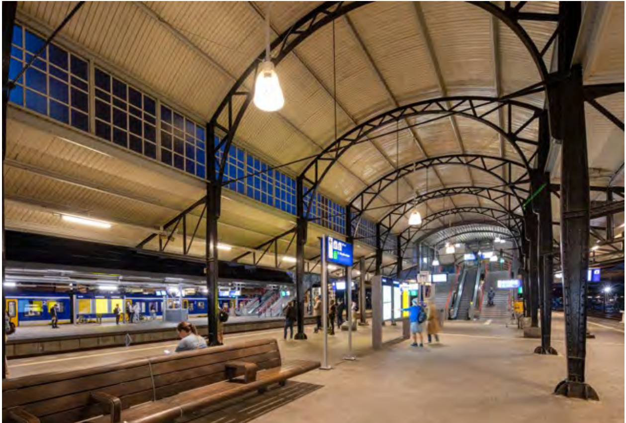
De perronkap met nieuwe led armaturen aan pendels in het hart van de kap en nieuwe led balken (lichtkeur 3000K) boven de geleidelijk onder de flanken van de kap.
