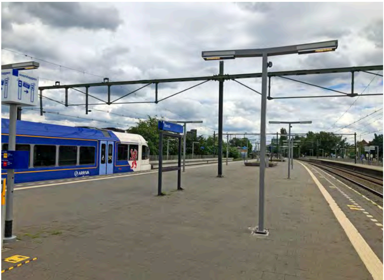
Bij de eind oplevering in juni 2020 zijn de grijze dimsensoren wel geplaatst. Hierboven zie je steeds 2 luidsprekers in een mast met dubbele uithouder. Op basis van voortschrijdend inzicht zouden we nu een luidspreker per mast, aan de spoorzijde, toepassen.
