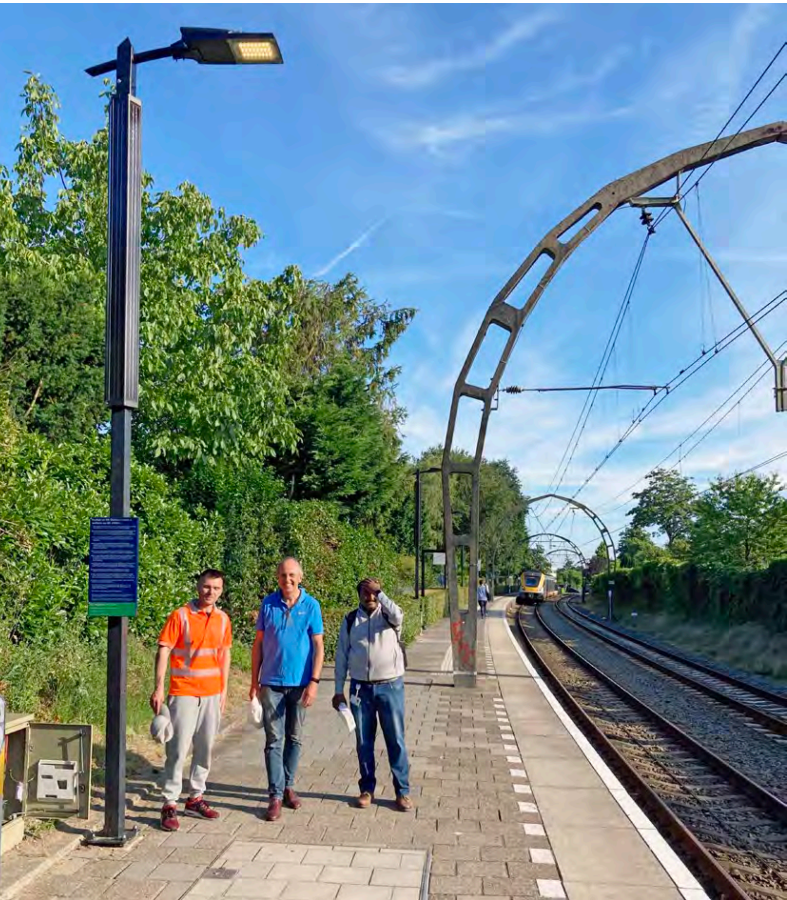
Signify Solar armatuur en panelen bij de inbedrijfstelling op Hilversum Sportpark (de auteur in het midden).
