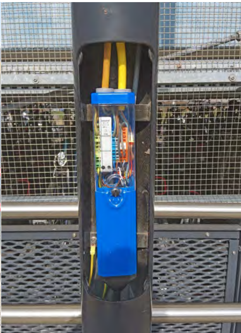
Sogexi aanraak veilige gesloten aansluitkast op station Oss.
