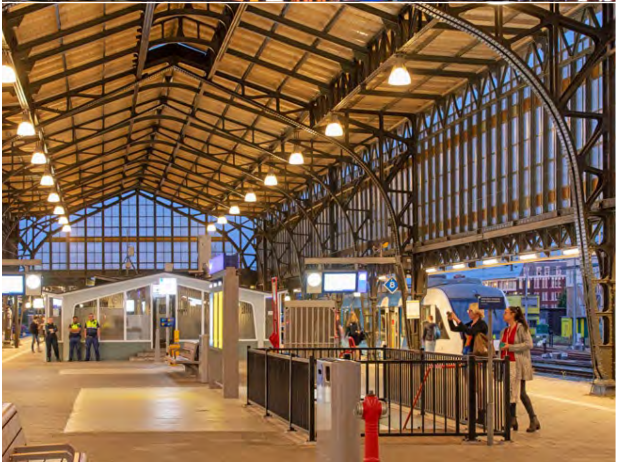
Monumentale kap van station Hengelo. Bestaande kelkarmaturen zijn voorzien van een nieuwe led-binnenwerken (retrofit modules).
